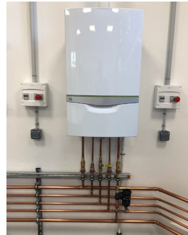
INSTALLATION DE CHAUFFAGE AVEC FILTRE DOMESTIQUE SUR RETOUR CHAUDIÈRE
