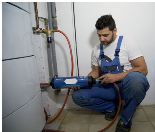
REPLISSAGE DU RÉSEAU VIA UNE CARTOUCHE DE DÉMINÉRALISATION
