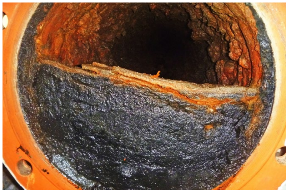
TUYAUTERIE GROS EMBOUÉE ET CORRODÉE
